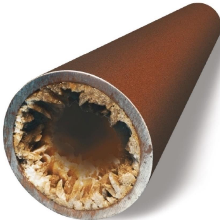
Figura 1.1: Formação de uma grossa camada de incrustações salinas sobre as paredes internas de um tubo em uma linha produtora de óleo. [1]
