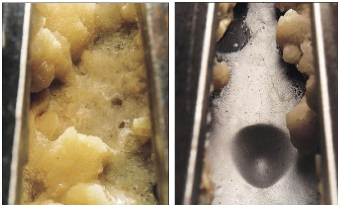
Figura 1.2: Tubulação com incrustações de carbonato de cálcio. À esquerda, o jateamento com água foi ineficiente na remoção do depósito. À direita, embora o jateamento com abrasivos tenha sido mais eficaz, causou também um dano inaceitável à tubulação. [1]
