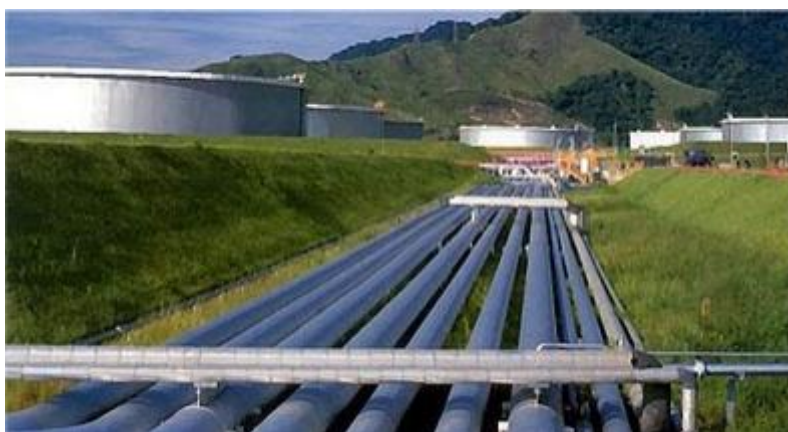
Figura 3 – Dutos para escoamento de petróleo cru.
