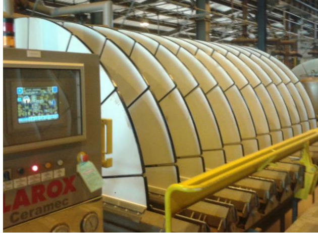
Figura 25 – Foto de um filtro cerâmico nas instalações da filtragem da Anglo American em São João da Barra no Rio de Janeiro.
