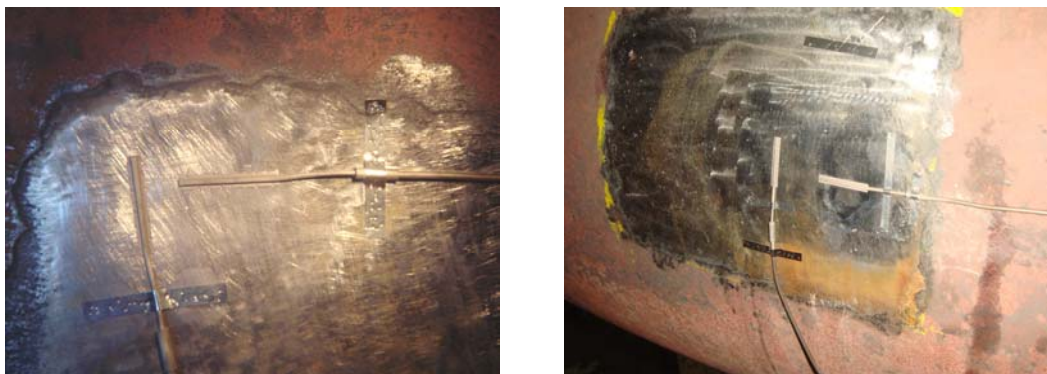
Figura 3.5.8 – Extensômetros instalados em dois dos pontos monitorados na linha de vapor principal.
